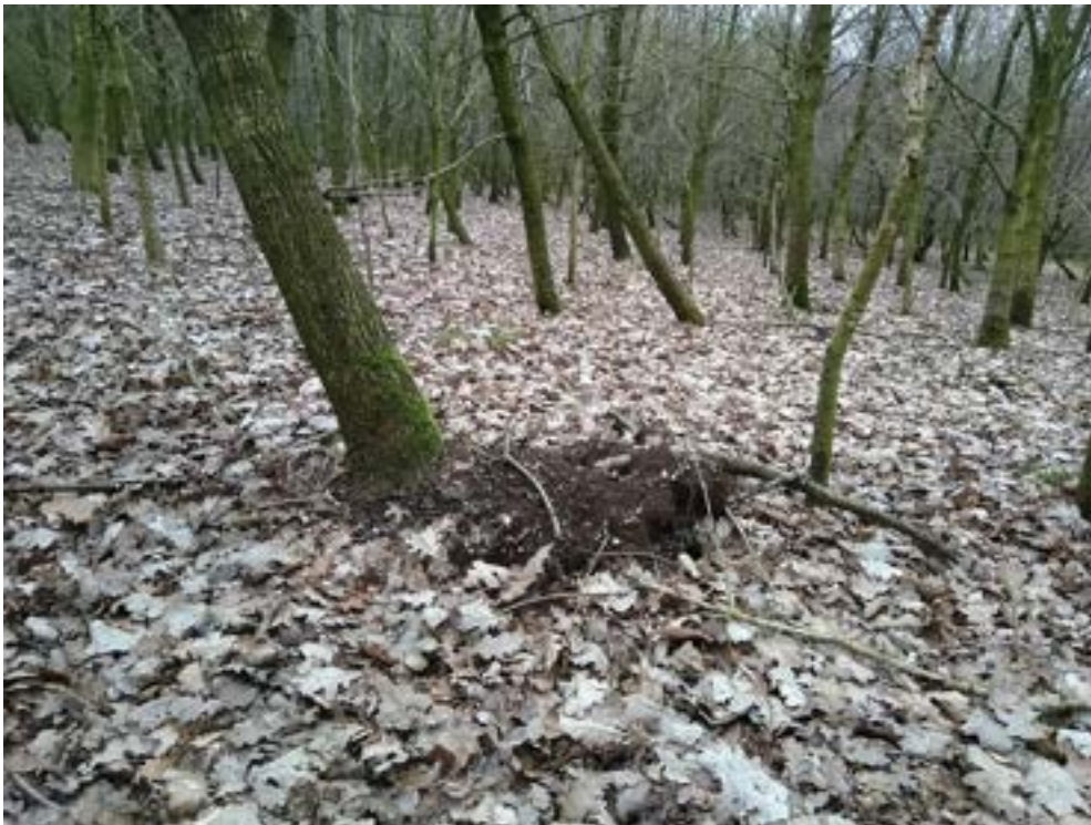
Figuur 67: Aangeplant bos bij de Vaassenseweg, waarbij bomen omvallen door instabiliteit van de verdroogde veenondergrond.
